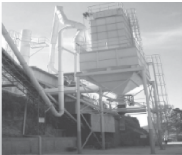
Figura 2.9 - Instalações de britagem, moagem e armazenamento de calcário.
