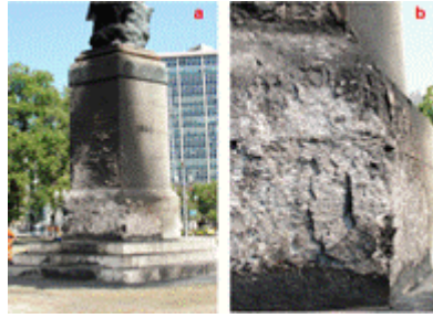
Figura 2A: Monumento pós-incêndio 2B detalhe da esfoliação da rocha.
