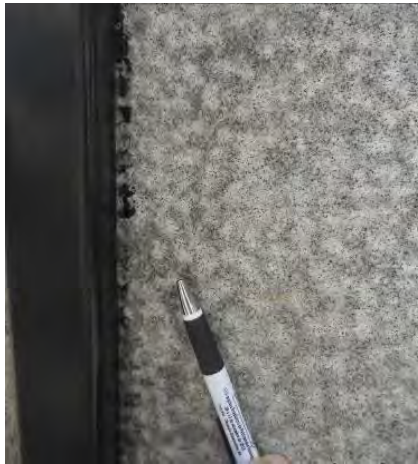
Figura 41. Manchamento de tinta e escurecimento das rugosidades "externas" do granito, causadas pelo picoteamento grosso utilizado no seu beneficiamento.
