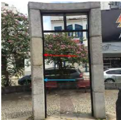
Figura 36. Alteração cromática na pilastra 5.
