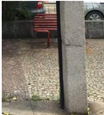
Figura 38. Perda de massa com restauro no bloco superior, perto do contato entre os blocos.
