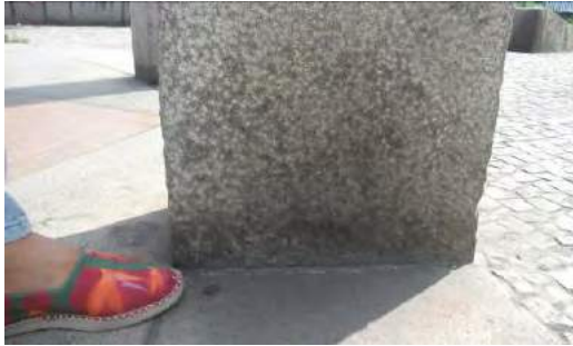
Figura 37. Depósito comumente encontrado na base das pilastras.
