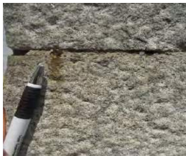
Figura 39. Manchamento avermelhado devido à oxidação da viga de ferro.
