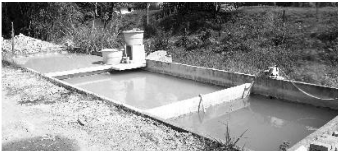
Figura 21 - Unidade de decantação constituída de três tanques. Foto: CETEM/MCTI, 2002.
