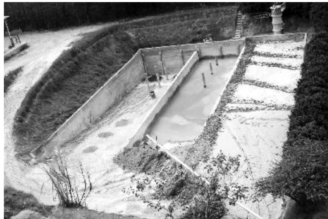
Figura 22 - Leitos de secagem. Foto: CETEM/MCTI, 2009.
