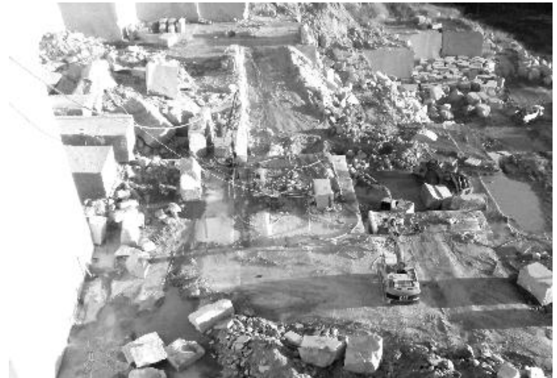
Figura 30 - Pedreira com avanço ascendente pelo método de pranchas verticais (esquerda da imagem) e descendente por bancadas altas (direita da imagem). Foto: CETEM/MCTI, 2013.
