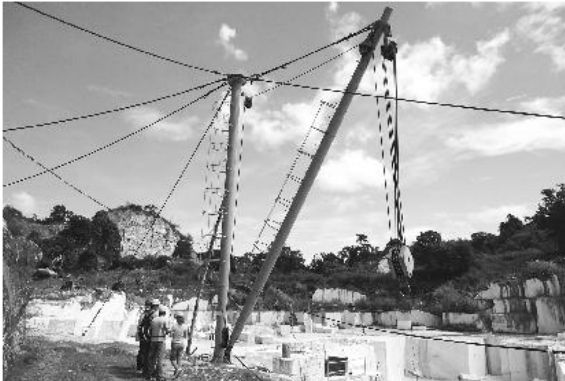
Figura 102 - Grua em pedra de mármore, no Brasil. Foto: CETEM/MCTI, 2012.
