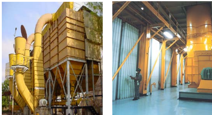
Foto 6: Filtro de mangas da usina 3. Foto 7 - Filtro de mangas da secagem.
